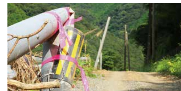
折れ曲がったままの電柱
