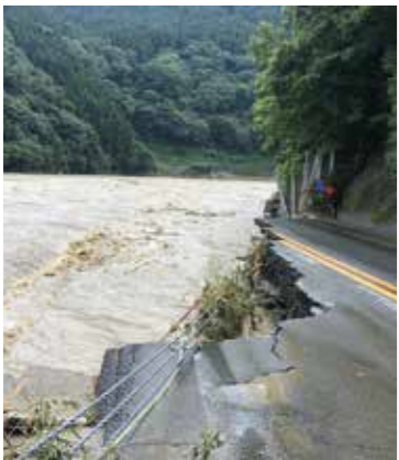
崩落した国道219号線(馬場)
