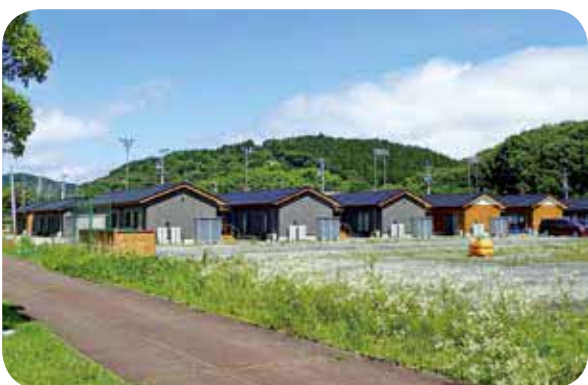
改修工事中の村有住宅と今後、改修・移築予定の仮設住宅
