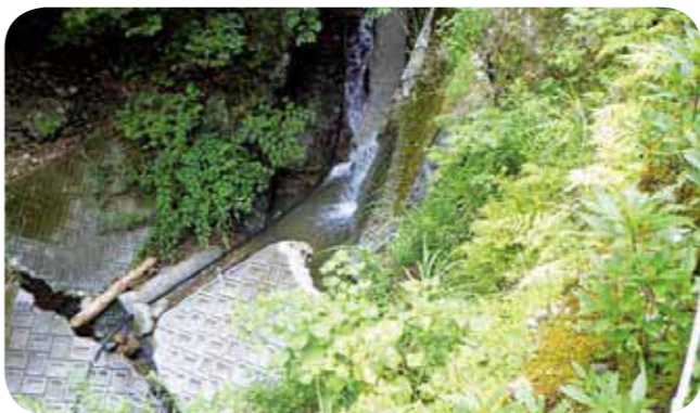
河川護岸が被災した亀割川
