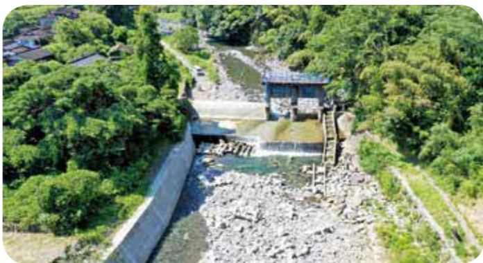
被災した茂呂葉頭首工
