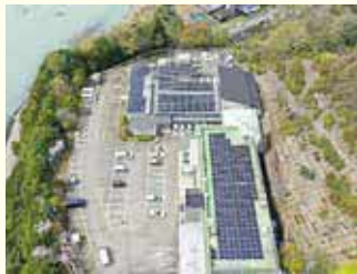
▲ 役場庁舎の太陽光発電設備
