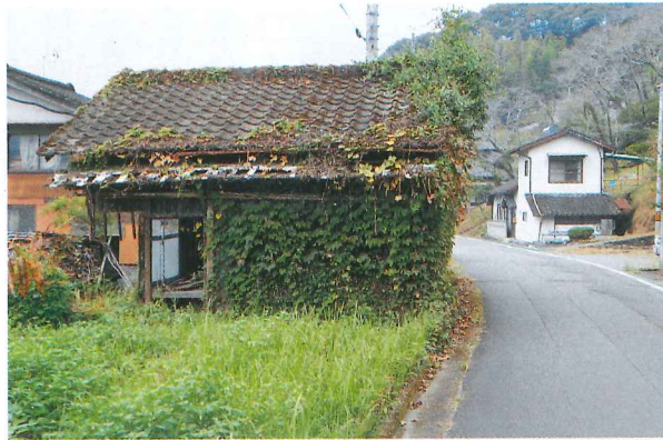
通学路側にある空き家
