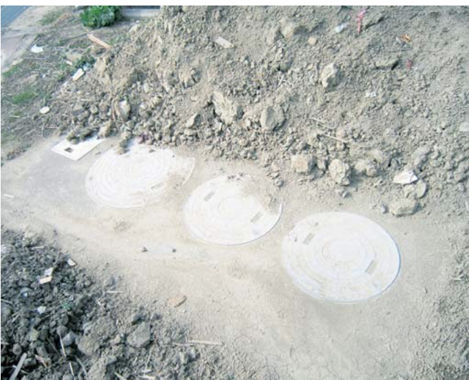
被災した浄化槽
