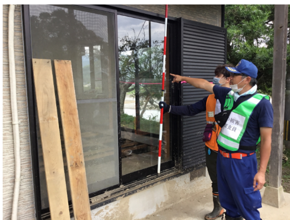
住家被害認定調査状況
