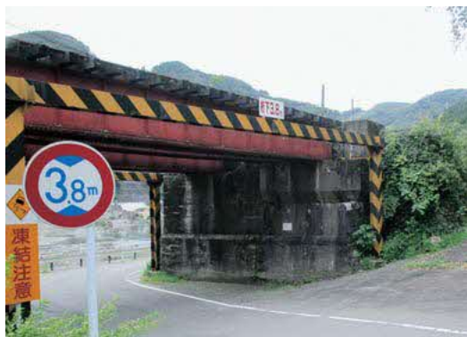
洪水時に水没する JR ガード下の道路
